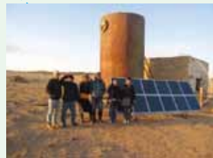
太陽光パネルによる揚水システム
